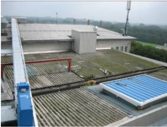
Asbestdach vor Sanierung
