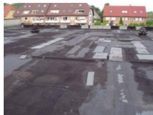
altes Dachpappendach mit Flickern
