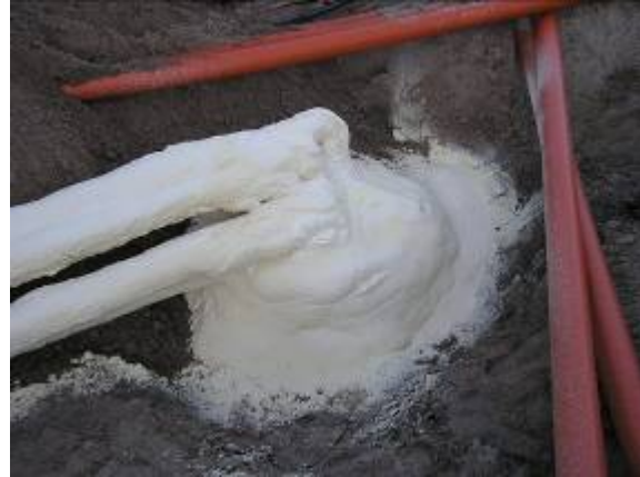
Tankanschluss für Heizung
