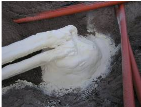
Tankanschluss für Heizung
